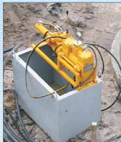
Zasilanie pompy płuczkowej - z agregatu hydraulicznego.
